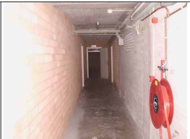
Trans 6 kelder, gang naar achterzijde
