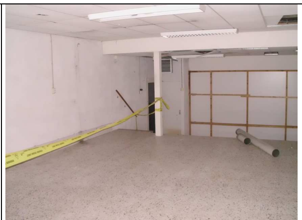
Nieuwstraat 25, asbestlocatie nabij buitendeur met Trans 4
