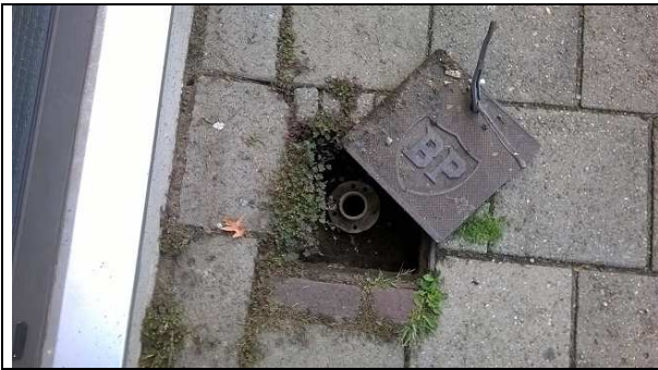
Ondergrondse HBO-tank in trottoir vóór Trans 6
