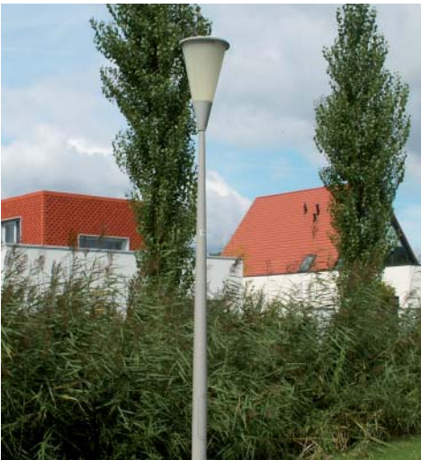
verlichtingsarmatuur 4 m hoogte
