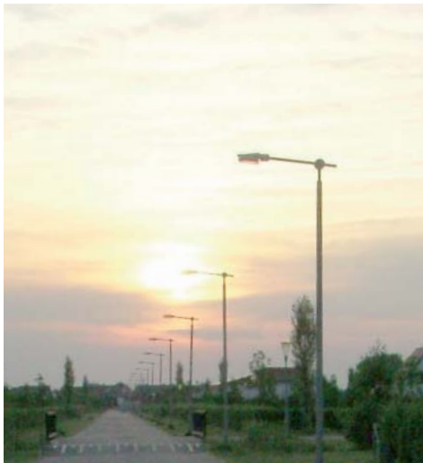
verlichtingsarmatuur 6 m hoogte
