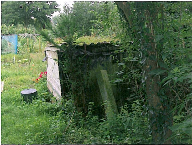
Schuurtje volkstuinten met asbesthoudende dakbedekking
