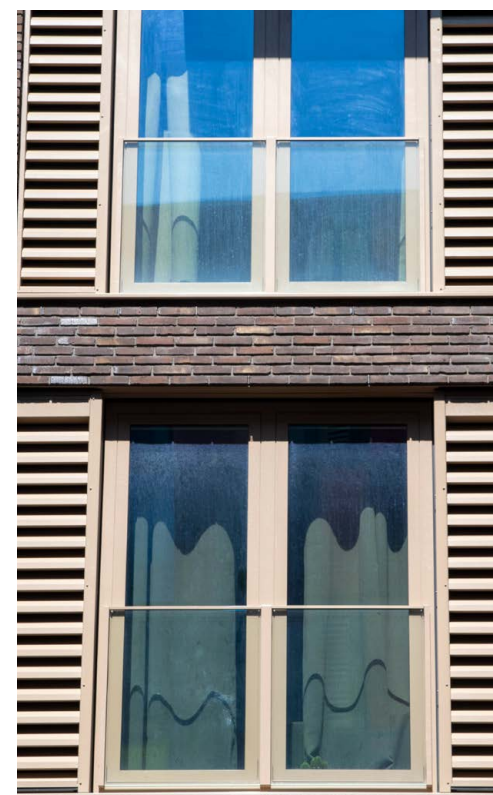
Geluidsluw spuien via muurroosters (Gare du Nord, Amsterdam)
