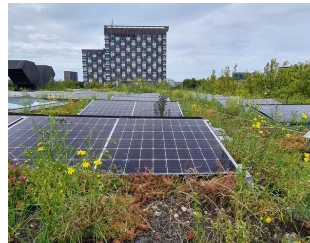
Combinatie van sedumdak en zonnepanelen (Van der Valk Solar Systems)
